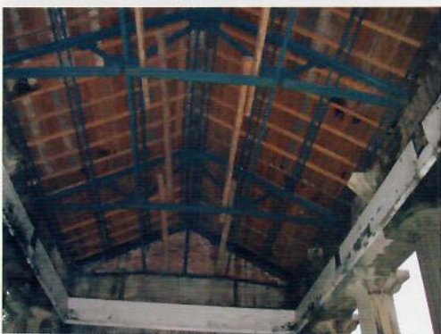
圖 10 斯年堂的屋頂天溝受雜物阻塞（上圖箭頭指示），造成斯年堂天花板內積水。
