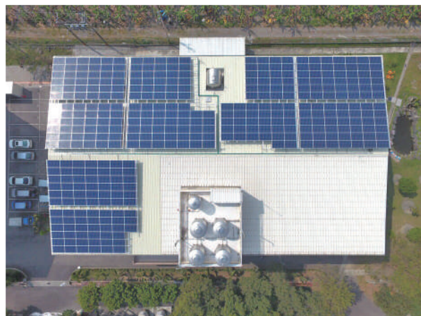
「大同之家」架設完成之太陽能板。
