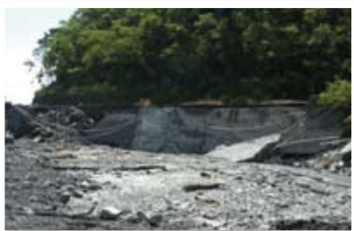
由於道路破壞嚴重，有時必須走在河床上，圖為愛國蒲村道路路基被掏空。
