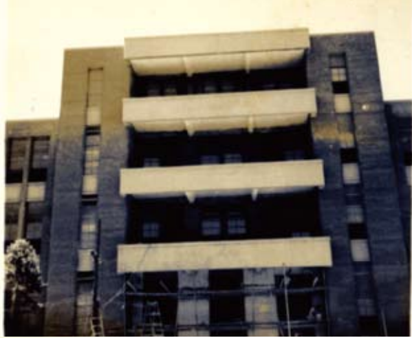
1958年森林館興建完成。圖為粉刷工程未完工時，施工鷹架尚未拆除。
